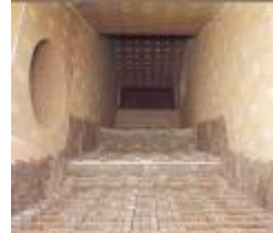
焼却炉の内部
