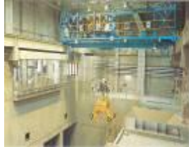
ごみピット・ごみクレーン
