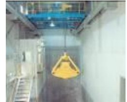
灰ピット・灰クレーン
