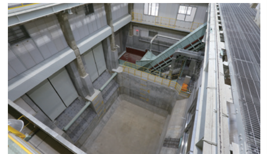
ごみピット(令和2年2月撮影) 不燃ごみを貯めるごみピットです。 約600㎡(約7日分)の不燃ごみを貯めることができます。
