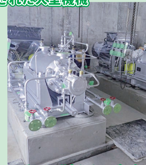
ボイラーへ給水するためのポンプ
